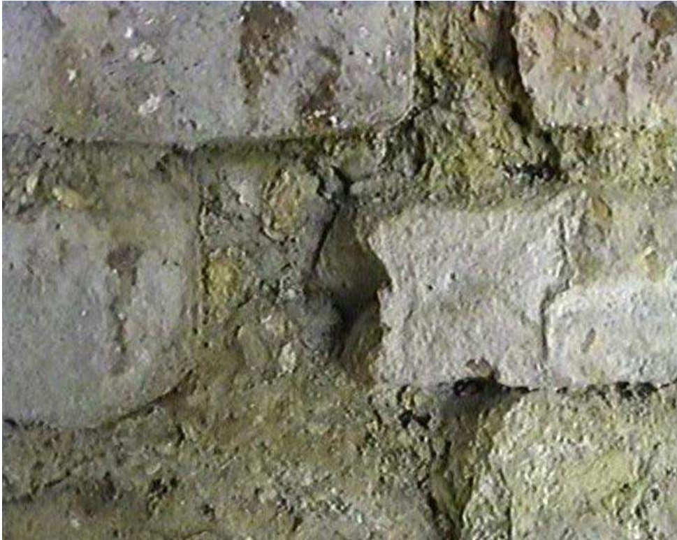
Parete della loggia Baldini. Foro di arma da fuoco
