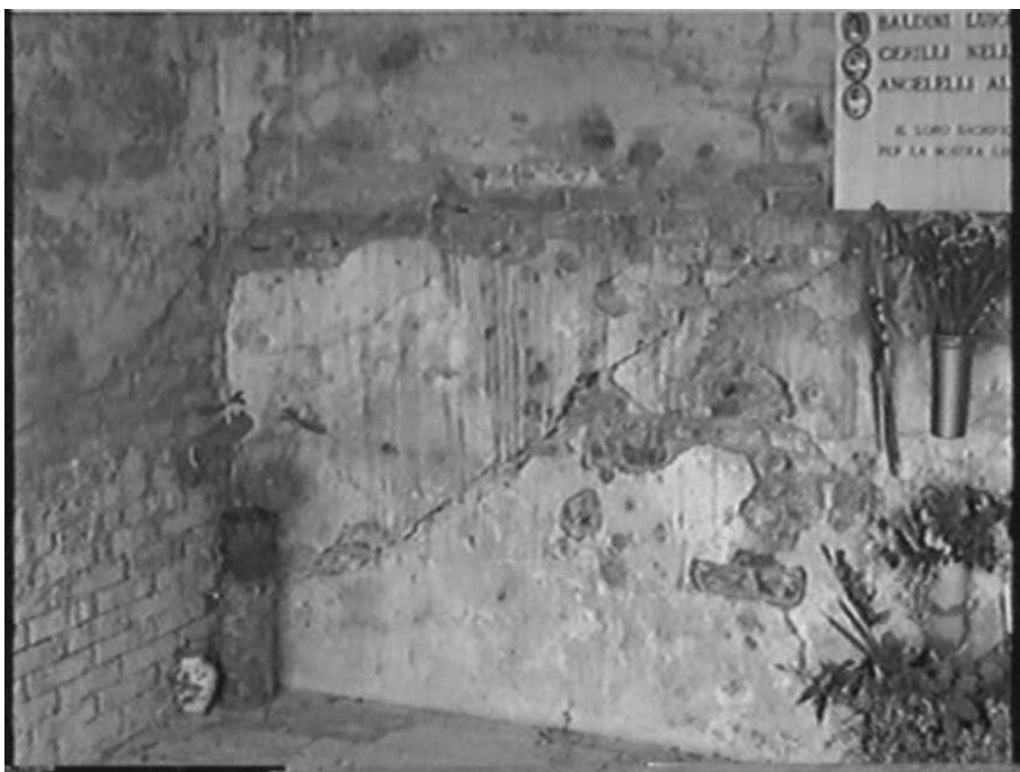
Muro interno della loggia con evidenti segni delle pallottole
